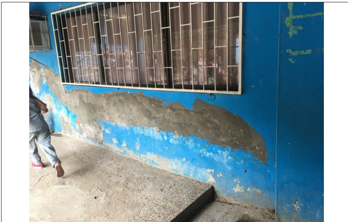
MAL ESTADO DE PINTURA INTERNA
