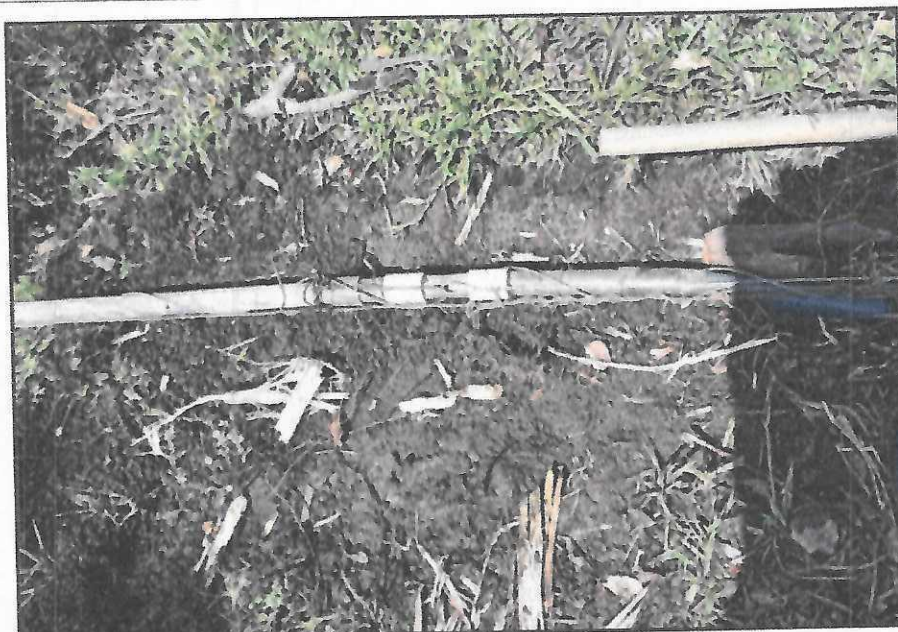
Fotografía No. 2: Adecuaciones improvisadas, las cuales generan desperdicio
