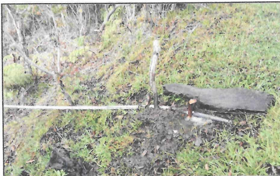
Fotografía No. 4: Desperdicios de agua presentados por las adecuaciones improvisadas.
