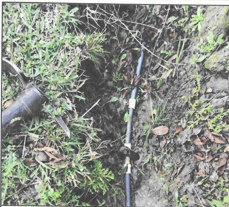
Fotografía No. 6: Tubería en mal estado
