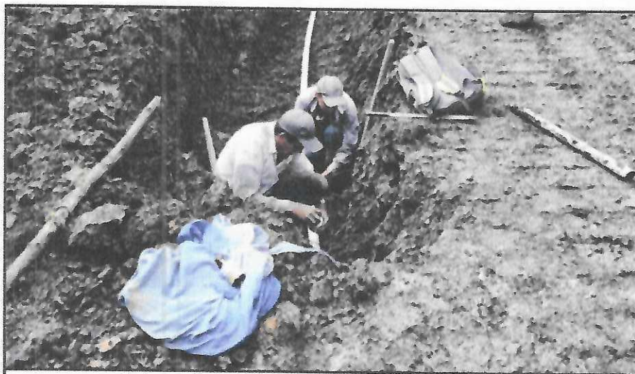
Fotografía No. 1: Tubería en malas condiciones
