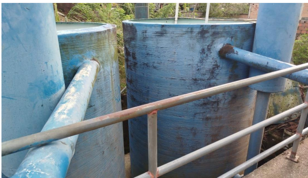
Fotografía 11 actuales filtros de PTAP - fuente propia
