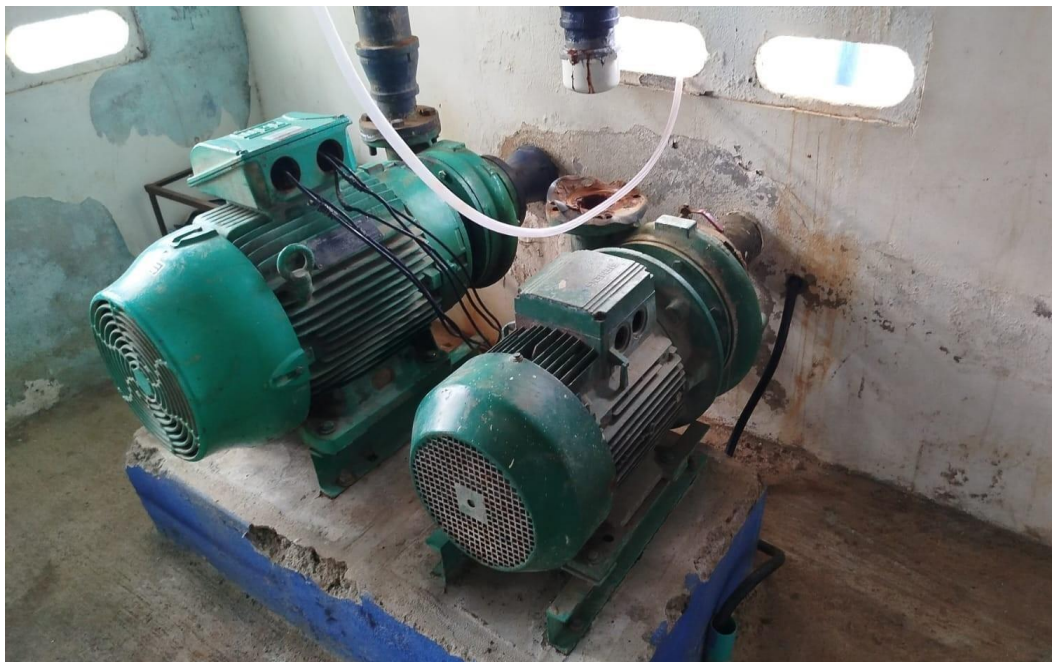
Fotografía 6 sala bombeo en tanque almacenamiento - fuente propia
