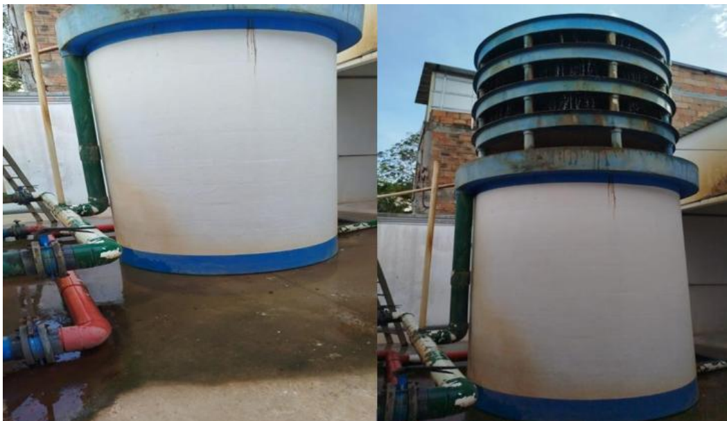
Fotografía 12 actual torre de aireación de PTAP - fuente propia
