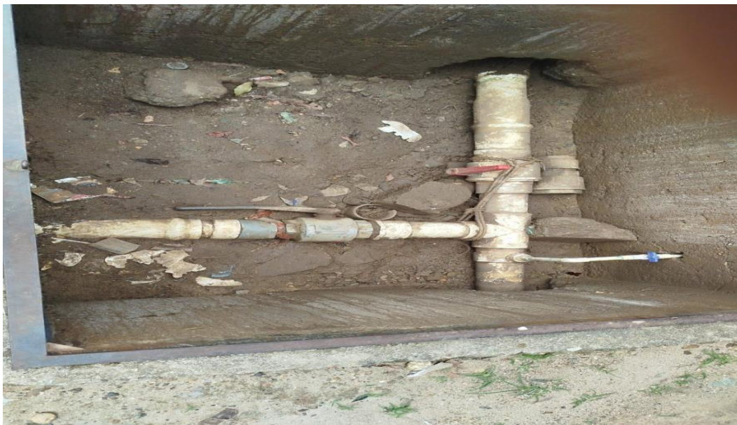
Fotografía 8 actual caja para control de caudal de agua tratada - fuente propia
