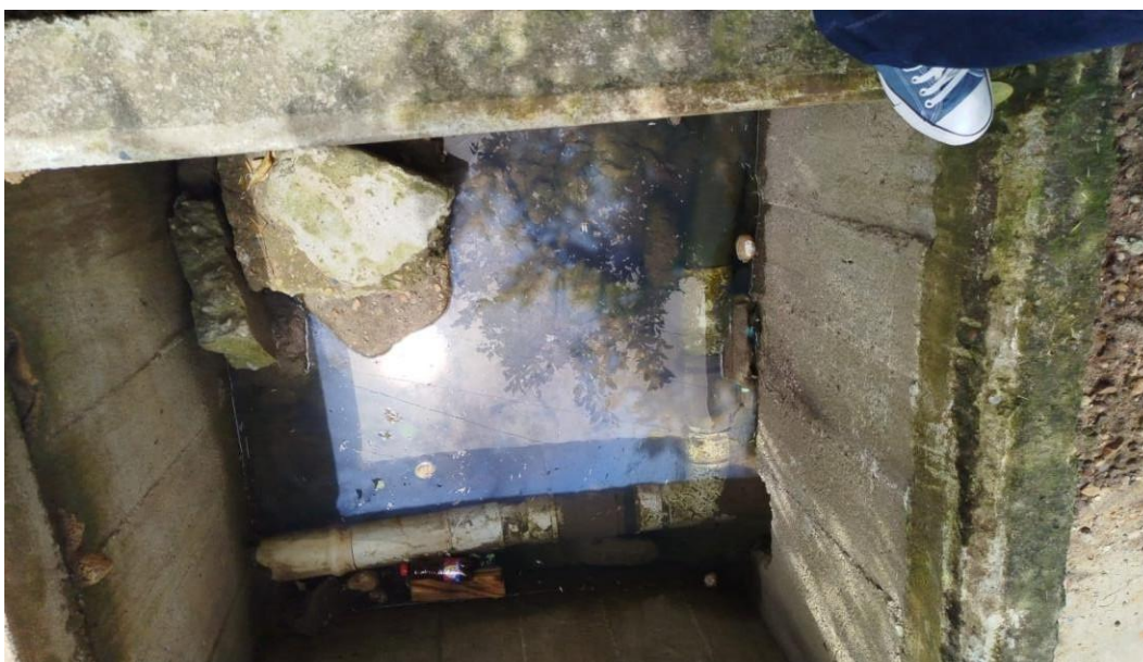
Fotografía 9 actual caja para control de caudal de agua tratada - fuente propia
