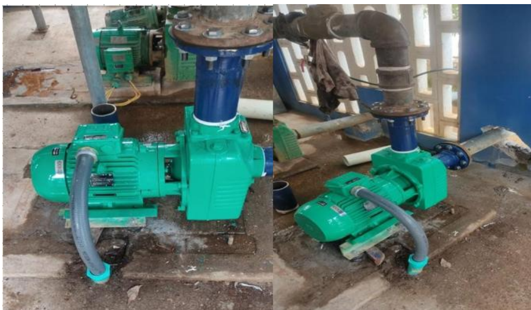
Fotografía 3 - Sala de bombeo en bocatoma actual - Fuente propia
