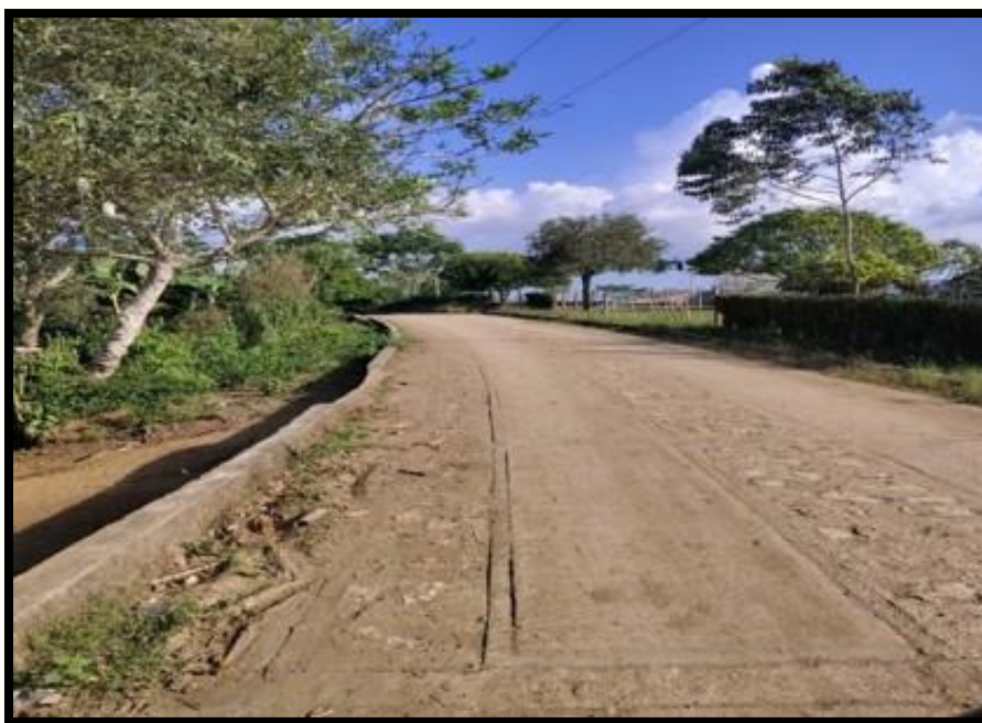
Imagen 14. Cunetas con sedimentos (Tuchín - San Juan tramo 3)
