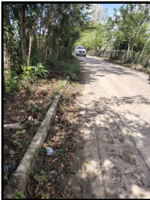
Imagen 28. Cunetas con sedimentos (Las Palomas)
