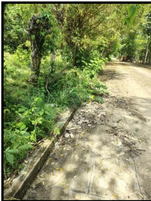
Imagen 34. Zona enmontada en laterales de las vías y cunetas (Nueva Colombia tramo 3)
