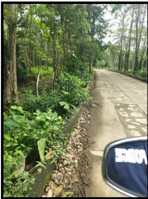
Imagen 7. Cunetas con sedimentos (Tuchín - Nueva Estrella)
