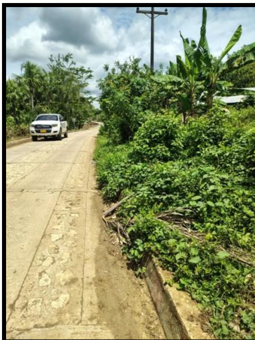
Imagen 12. Zona enmontada en laterales de las vías y cunetas (Tuchín - San Juan tramo 2)
