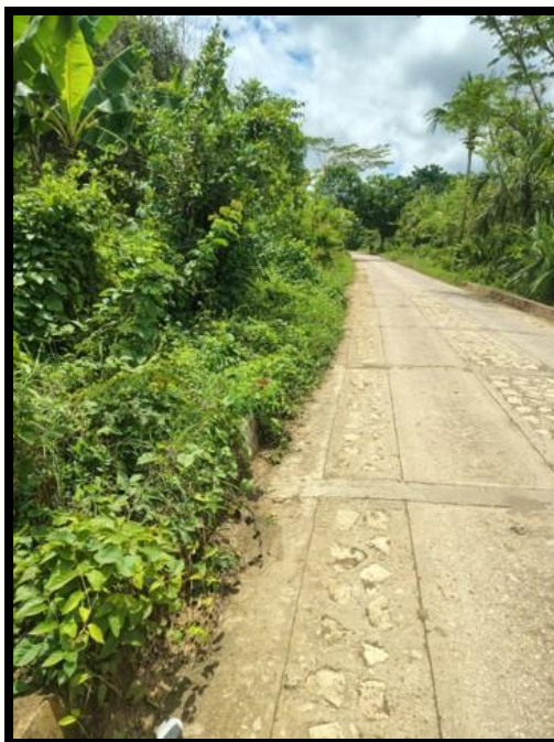
Imagen 10. Zona enmontada en laterales de las vías y cunetas (Tuchín - San Juan tramo 1)
