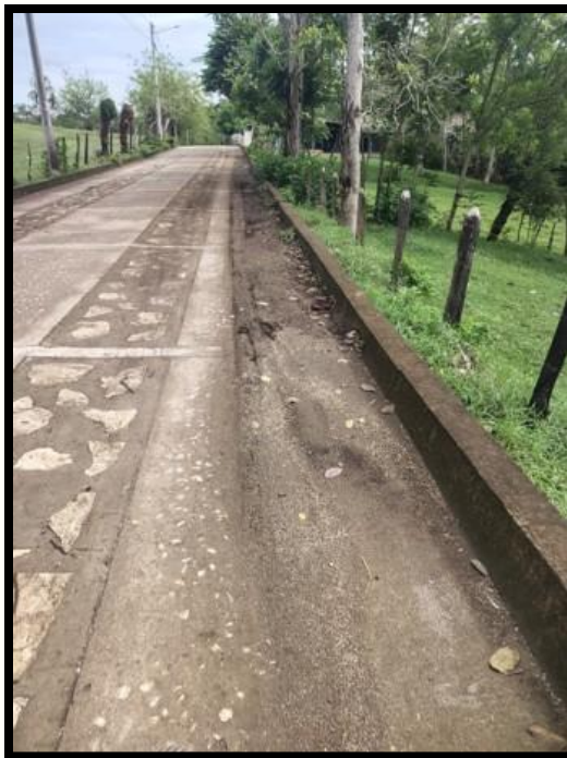
Imagen 8. Cunetas con sedimentos (Tuchín - Nueva Estrella)
