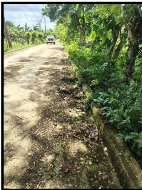
Imagen 33. Zona enmontada en laterales de las vías y cunetas (Nueva Colombia tramo 3)
