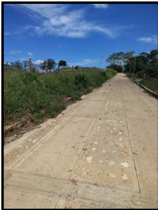
Imagen 24. Zona enmontada en laterales de las vías y cunetas (Patapelua tramo 4)
