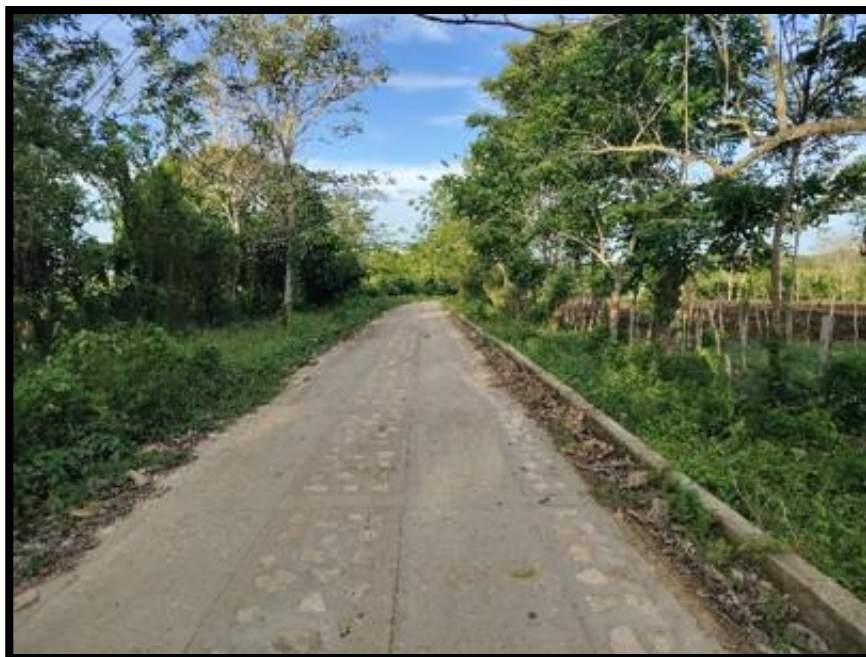
Imagen 4. Cunetas con sedimentos (Barbacoas - Molina tramo 1)
