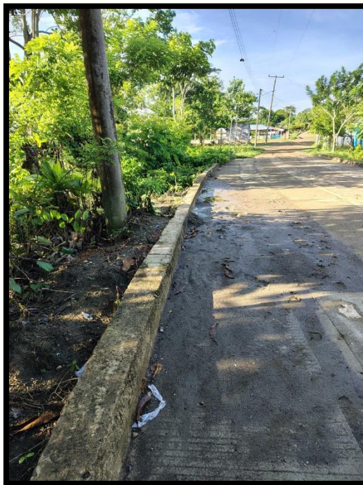
Imagen 20. Cunetas con sedimentos (Patapelua tramo 2)
