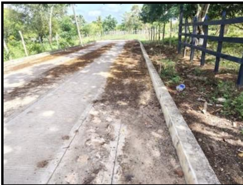
Imagen 32. Cuentas con sedimentos (Nueva Colombia tramo 2)
