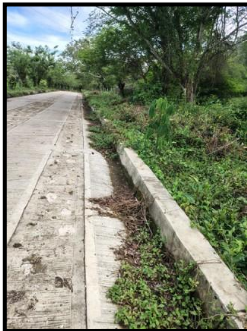
Imagen 15. Zona enmontada en laterales de las vías y cunetas (Barbacoas)
