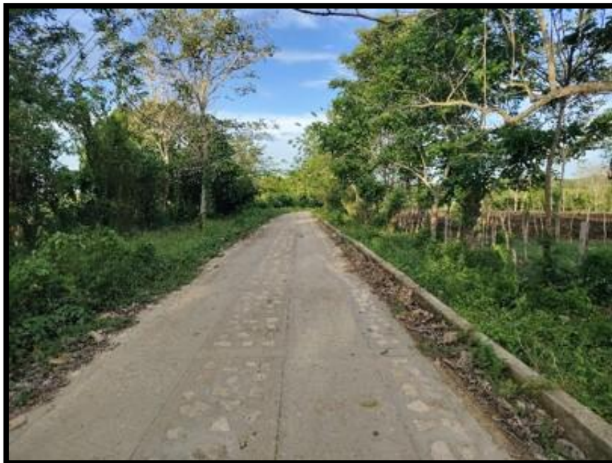
Imagen 4. Cunetas con sedimentos (Barbacoas - Molina tramo 1)
