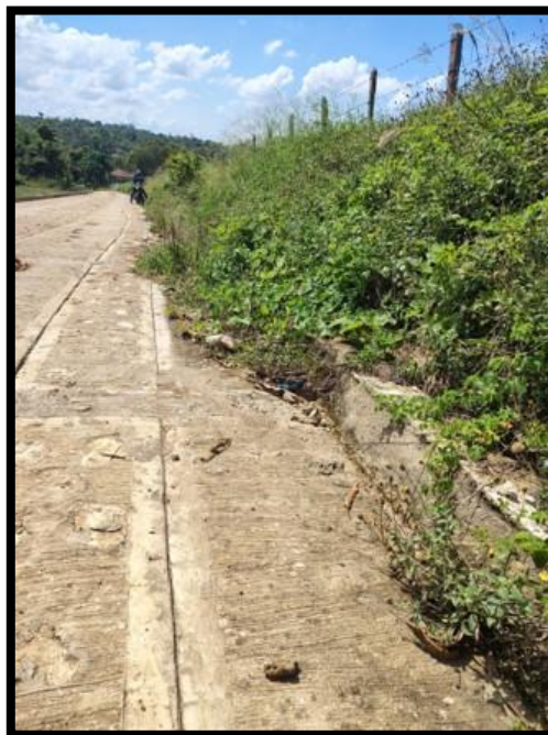
Imagen 23. Zona enmontada en laterales de las vías y cunetas (Patapelua tramo 4)
