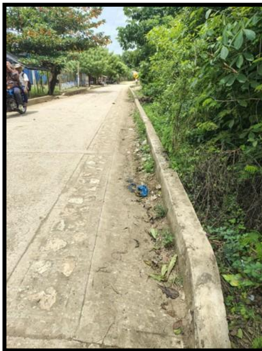
Imagen 11. Zona enmontada en laterales de las vías (Tuchín - San Juan tramo 2)
