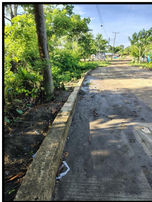
Imagen 20. Cunetas con sedimentos (Patapelua tramo 2)
