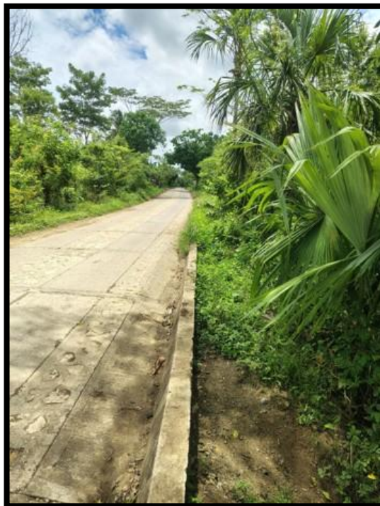
Imagen 9. Zona enmontada en laterales de las vías (Tuchín - San Juan tramo 1)
