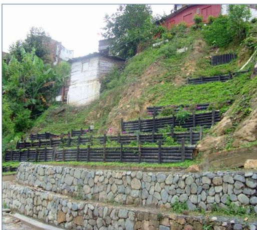
Ilustración 7 Erosión por actividades de excavación
