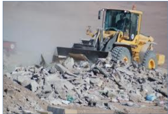
Ilustración 6 Escombros y materiales de construcción
