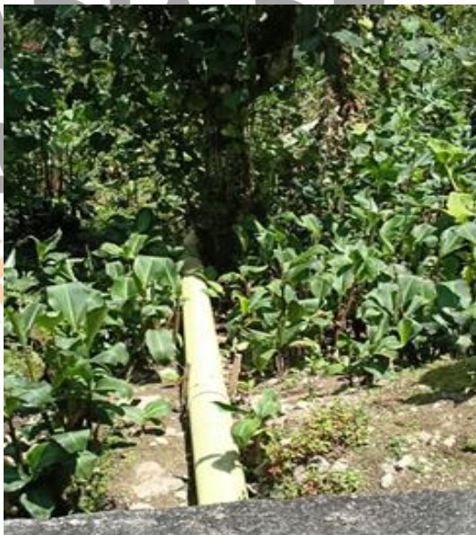
Descole provisional como medida de mitigación para evitar el desbordamiento de aguas residuales por las camaras de inspección
