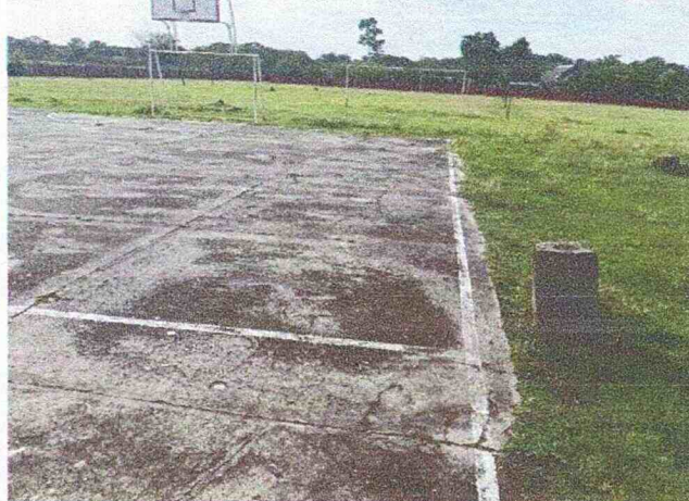
Fisuramiento y presencia de humedad y suciedad.
