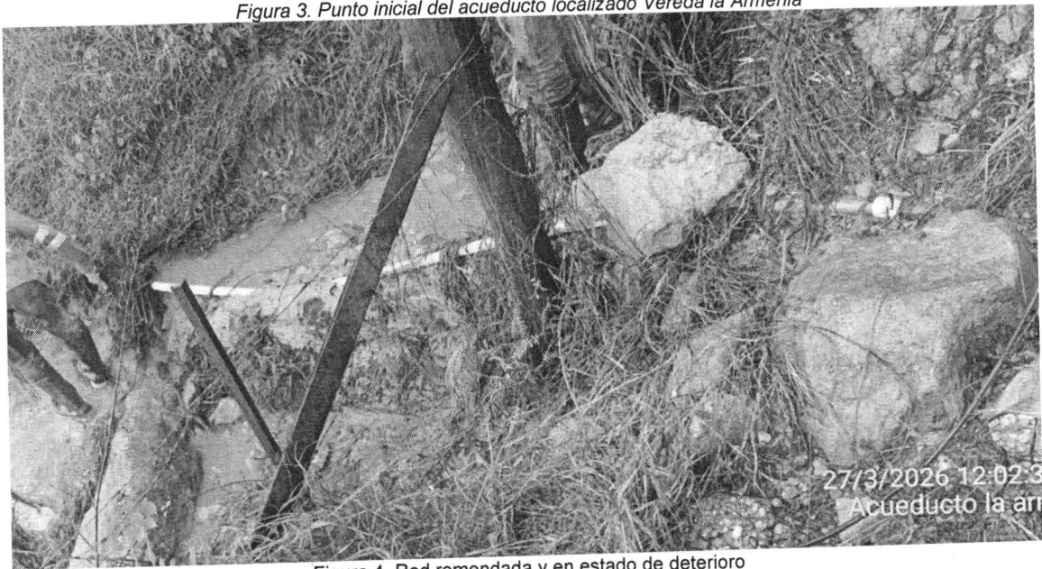
Figura 4. Red remendada y en estado de deterioro
