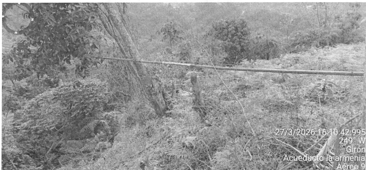
Figura 6. Red y guayas con necesidad de mantenimiento. Fuente: secretaria de Infraestructura.
