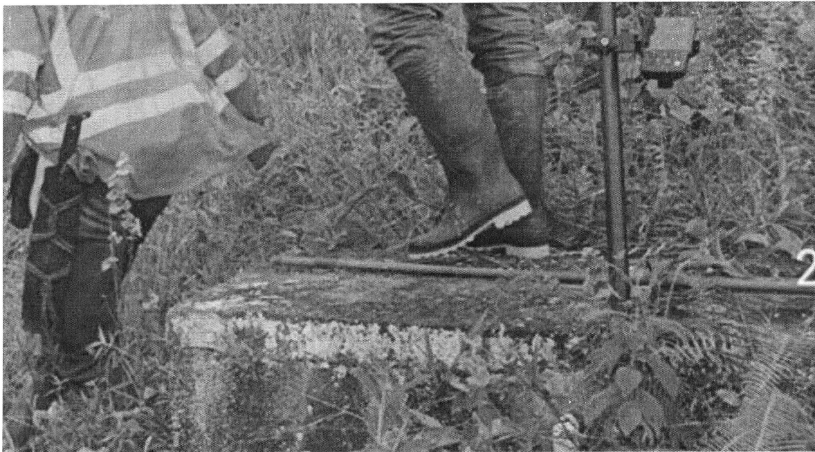
Figura 5. Estructuras de purga con avanzado y notorio estado de vetustez
