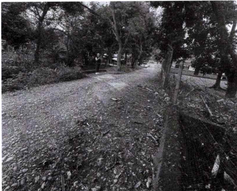
Fuente Propia: Estado actual Alcantarilla vereda el Crucero
