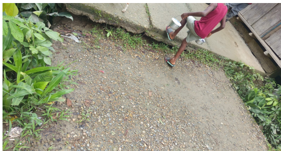
Figura 1.2. Registro fotográfico del estado actual de los dos puentes peatonales del corregimiento de San Antonio.
