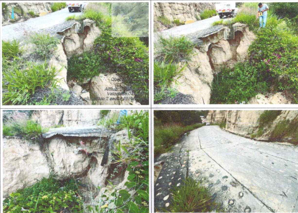
Imágenes del estado actual de la vía a intervenir - Inestabilidad de la banca PR 0+340.00 (sector El Reposo)
