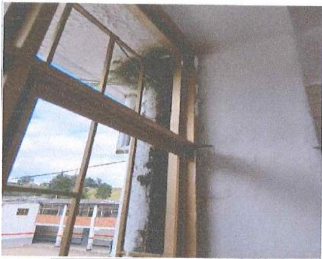
Despedimiento de la ornamentación como consecuencia de los asentamientos que viene prestando la infraestructura
