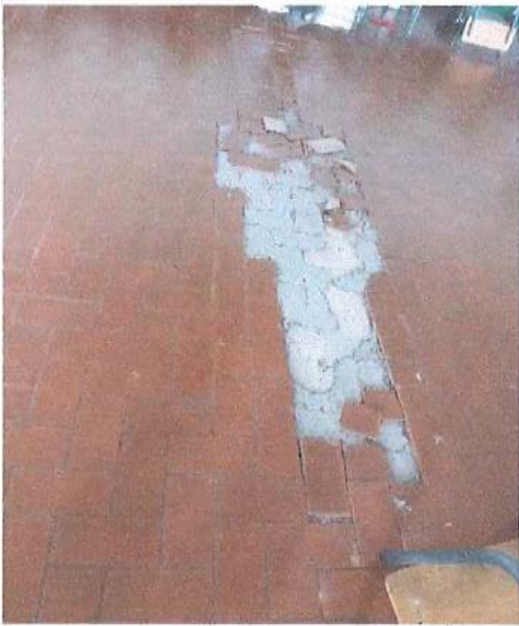
Falla de la placa de piso como consecuencia de los asentamientos que presenta la edificación
