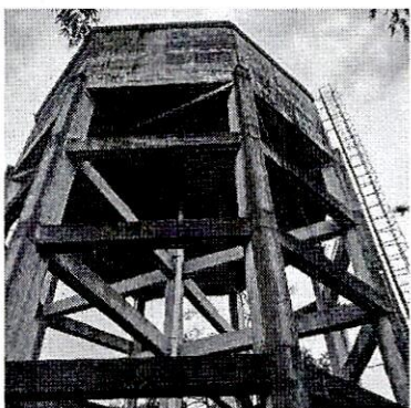
Tanque elevado de almacenamiento
