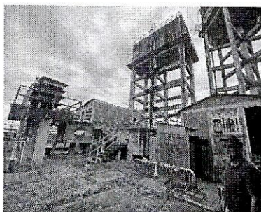
PTAP – Infraestructura existente
