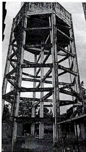
Tanque elevado de almacenamiento
