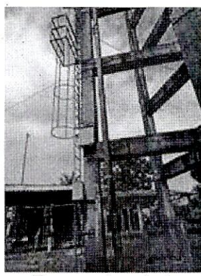
Tanque elevado de almacenamiento PTAP
