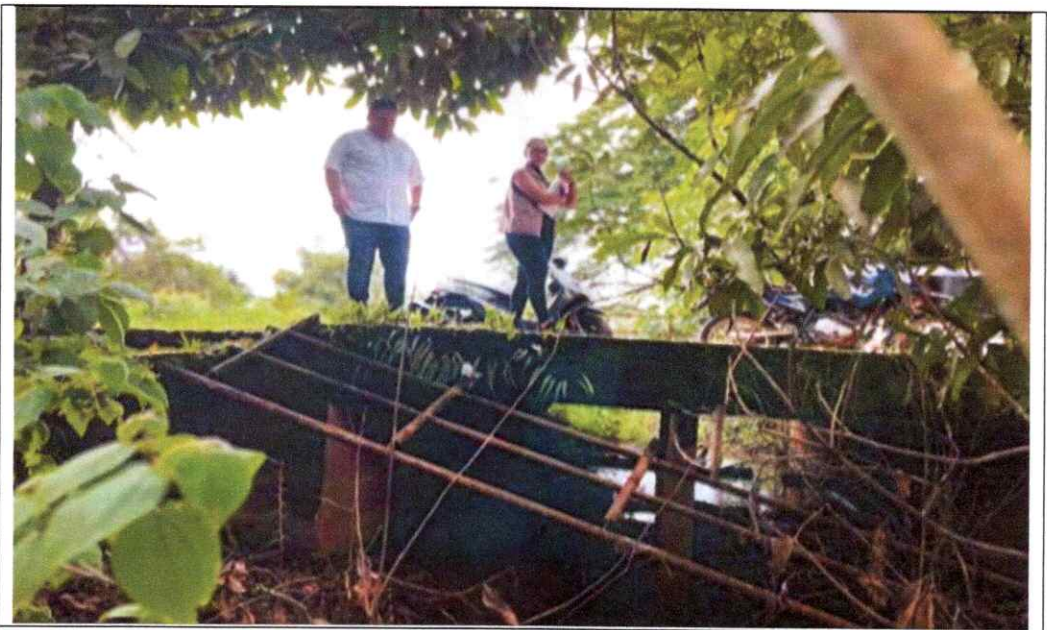
Vertimiento Entrada Aeropuerto
