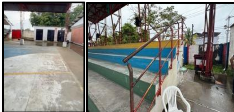
Ilustración 3: Estado actual de cancha, barandas, graderías y demás elementos
