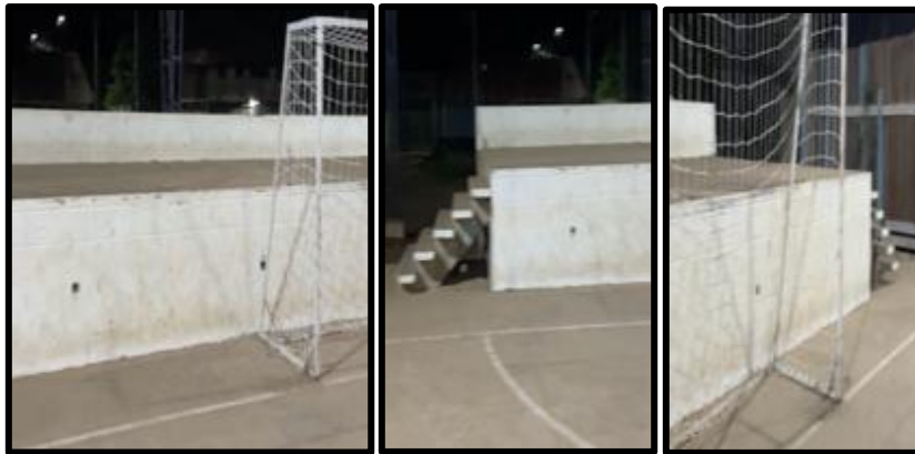
Ilustración 29: Estado de Muros I:E. Manuel Quintín Lame.
