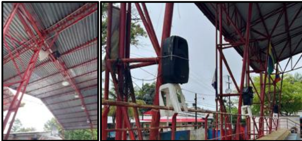
Ilustración 8: luminarias a ser actualizadas y red eléctrica.
