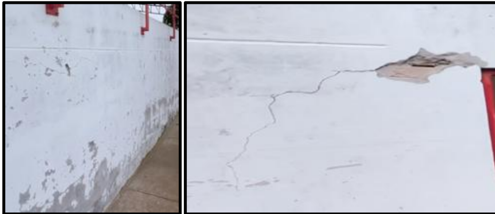
Ilustración 18: Estado de los pañetes exteriores en graderías.
