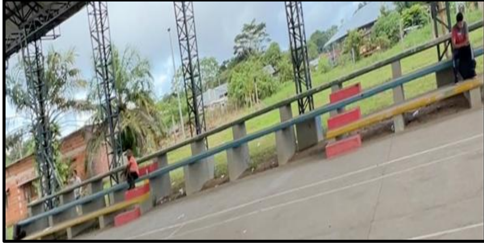
Ilustración 34: Graderías objeto del mantenimiento correctivo.
