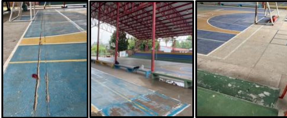
Ilustración 16: Áreas a intervenir con presencia de grasas y otros tipos de residuos contaminantes.
