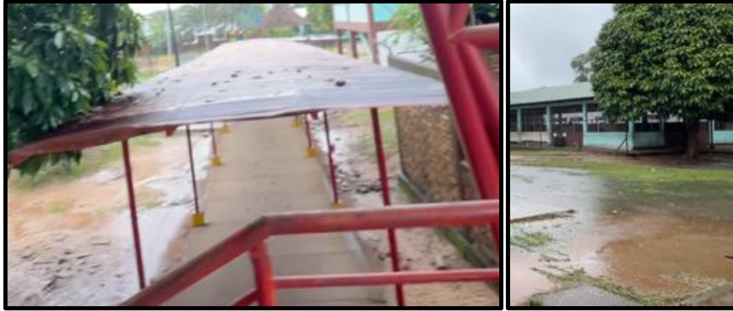
Ilustración 20: Área carente de iluminación adecuada
