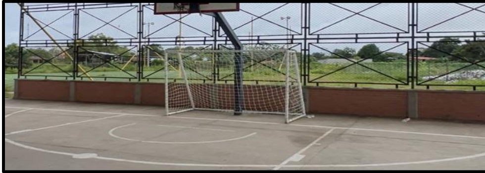
Ilustración 32: Malla contra impacto objeto del mantenimiento preventivo.
