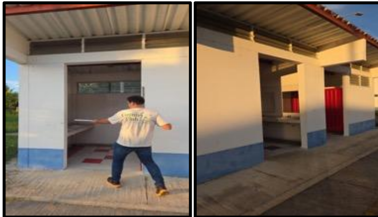
Ilustración 40: Faltante de puertas en baterías sanitarias, hombres y mujeres.
