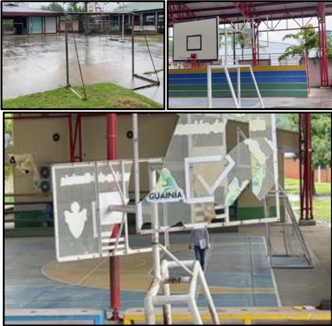
Ilustración 19: Estructura Deportiva Metálica en deterioro y faltante.
