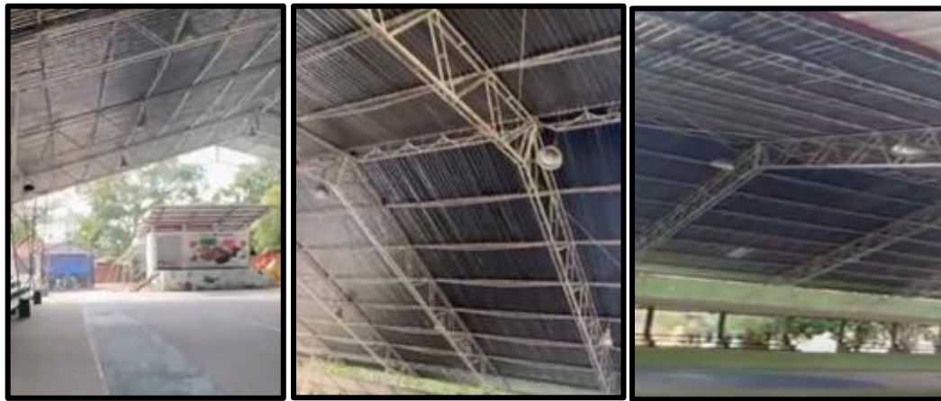
Ilustración 15: Iluminación en halógeno en deterioro.
