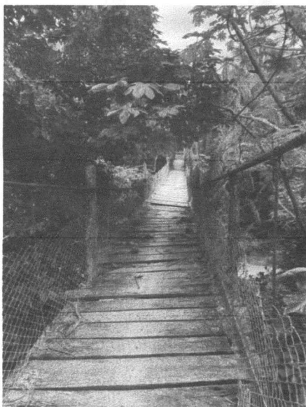
Foto 3 — Superficie de rodadura en madera con tablones fracturados y desalineados
