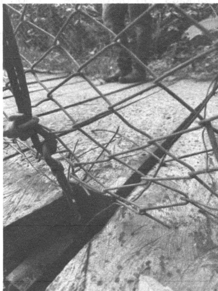
Foto 5 — Malla eslabonada sin tensionar, con pérdida de apoyos intermedios en el tramo de acceso
