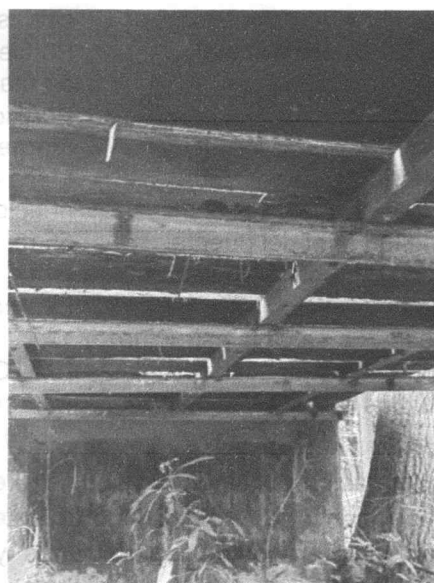
Foto 2 — Vista general de la parrilla metálica de soporte, con manchas de corrosión y pérdida de recubrimiento
