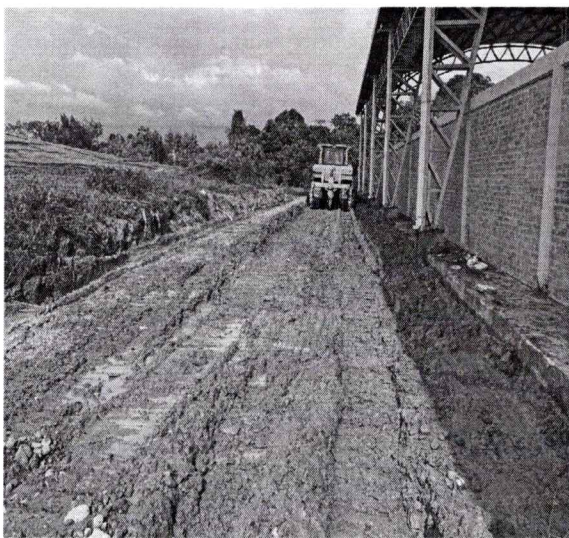
Subrasante sin estructura granular, ahuellamiento severo.
