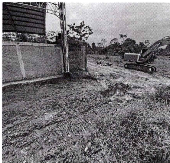
Lodazal profundo, huellas de vehiculo, residuos dispersos y ausencia total de afirmado.
