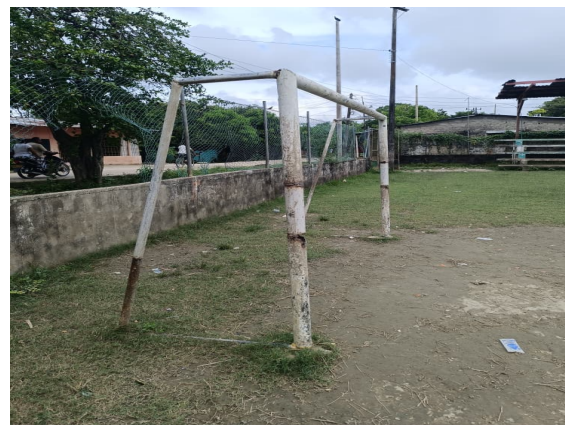
Foto 04: Se evidencia el estado actual de una de las porterías de la cancha, la cual presenta deterioro en su estructura y ausencia de malla.
