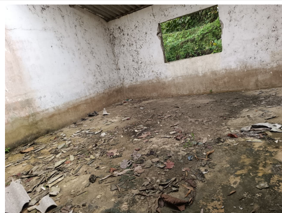
Foto 02: Se observa el estado actual de uno de los espacios interiores de la edificación, evidenciándose superficies de piso sin acabado, muros que requieren intervención.
