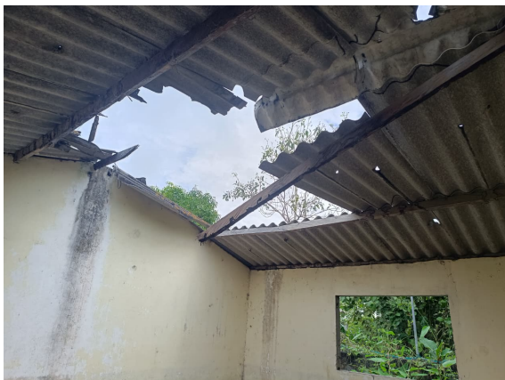
Foto 01: Se evidencia deterioro significativo de las láminas de cubierta, con presencia de roturas, perforaciones y pérdida de secciones.
