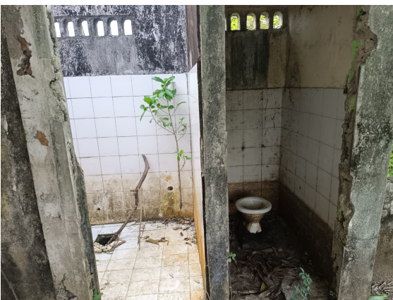
Foto 03: Se evidencia el deterioro de las unidades sanitarias de la edificación, observándose aparatos sanitarios y enchapes en condiciones deficientes, así como áreas que requieren intervención.
