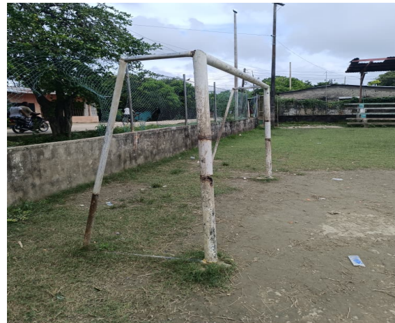
Foto 04: Se evidencia el estado actual de una de las porterías de la cancha, la cual presenta deterioro en su estructura y ausencia de malla.
