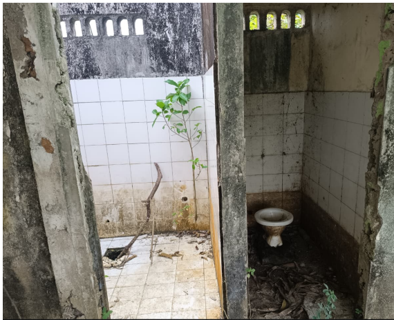
Foto 03: Se evidencia el deterioro de las unidades sanitarias de la edificación, observándose aparatos sanitarios y enchapes en condiciones deficientes, así como áreas que requieren intervención.
