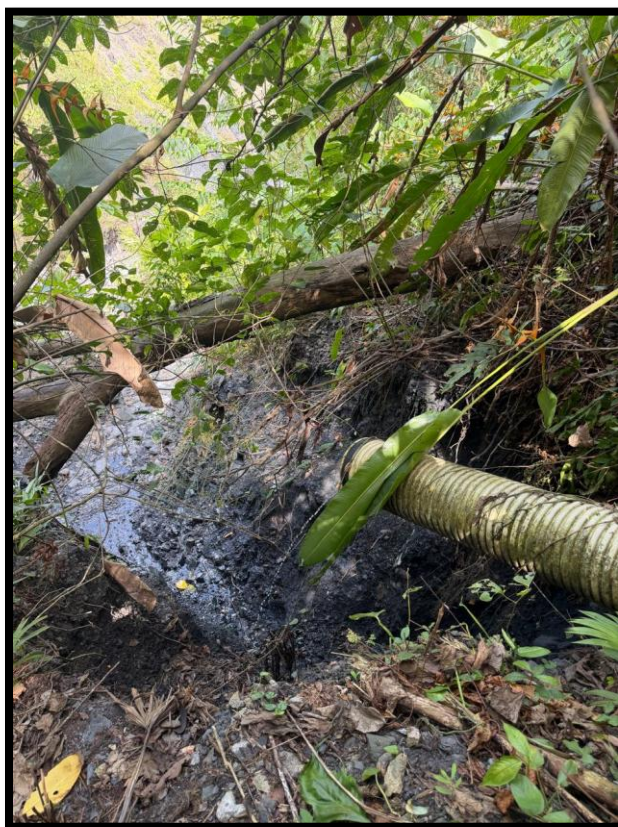
Registro fotográfico 1. Condición observada en el barrio “Francisco Murillo” – descole hacia la quebrada La Chama.
