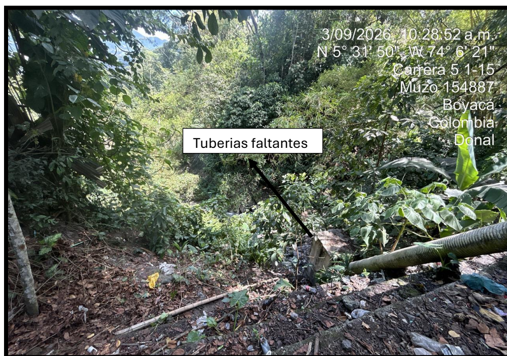
Registro fotográfico 2. Sector del descole de alcantarillado pluvial en el barrio San Jorge, hacia la quebrada La Chama.
