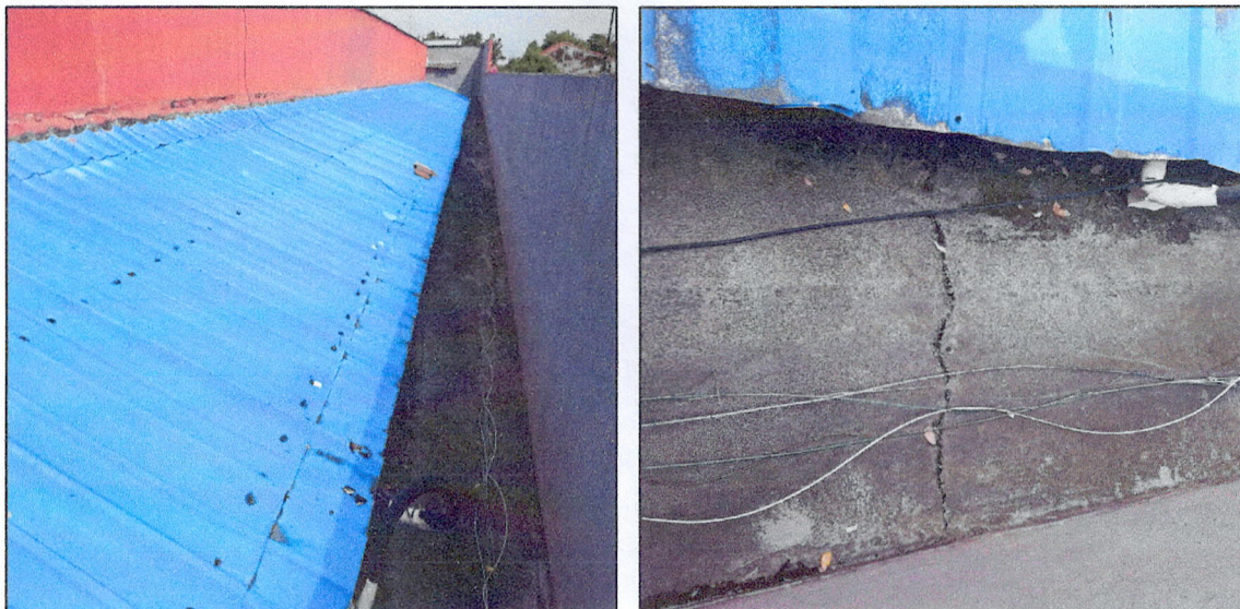
Ilustración 2. Viga canal en concreto presenta grietas y filtraciones de agua lluvias al interior de las instalaciones del Centro de Convivencia del municipio de Arauquita.
